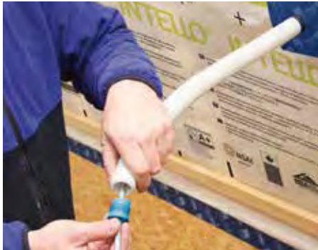
Заглушки STOPPA изолируют вывод кабеля из гофротруб.
